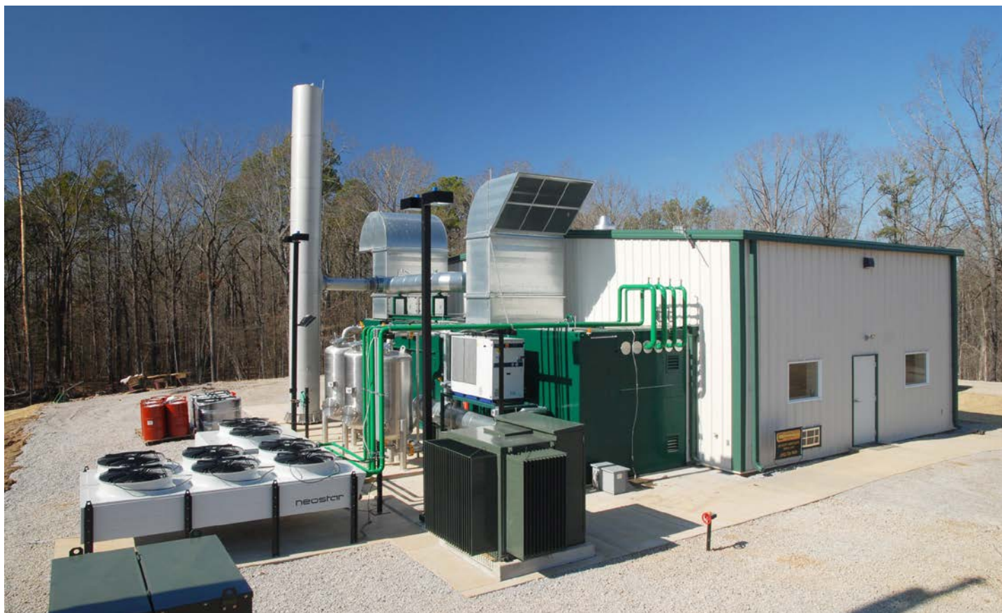
Звукоизолированные контейнеры для установок комбинированного цикла покрашены компанией Wenker.
